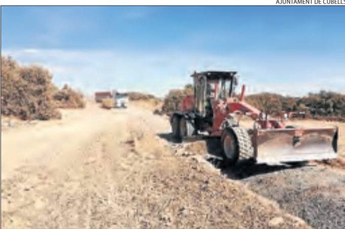
Cubells millora els camins ■ L'ajuntament de Cubells porta a terme les obres de millora en un total dotze quilòmetres de camins del municipi utilitzant àrids reciclats.
