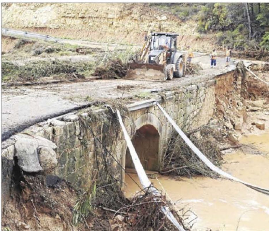
La carretera d'accés al Vilosell, que va quedar tallada durant el dia. L'aigua va passar per sobre de la via i no va ser
