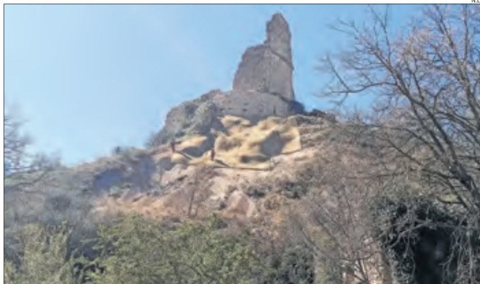
Castell de Conques. Aquesta intervenció té per objectiu estabilitzar el terreny i consolidar l'assentament de cara a conservar-lo davant dels agents meteorològics.
