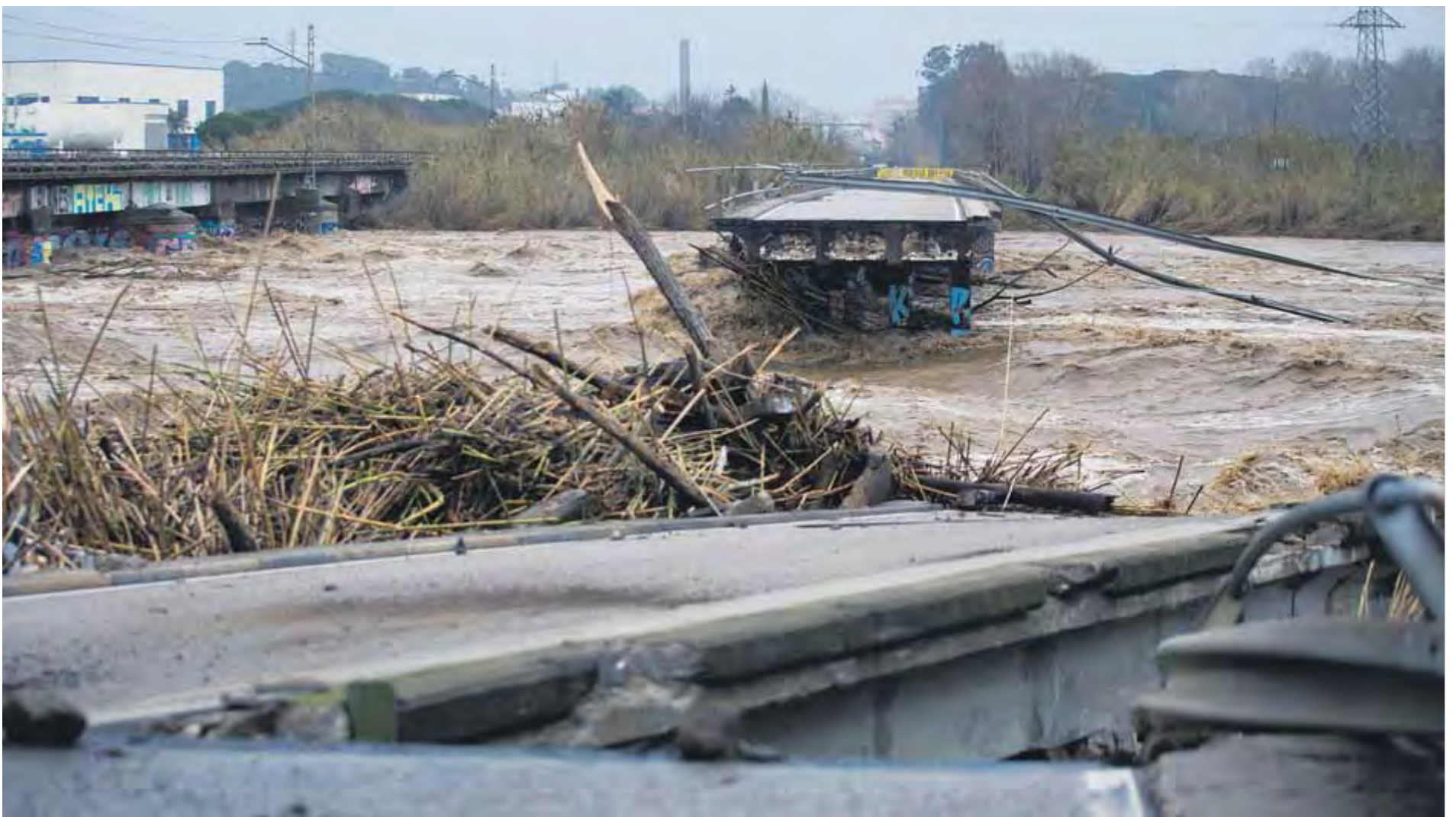
Un dels dos ponts que la Tordera va destrossar ahir a Malgrat. El riu desbordat ha deixat sense servei ferroviari la zona durant sis mesos ■ QUIM PUIG
