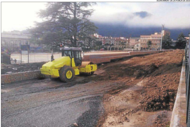
Estat de les obres d'adequació del parc Alcalde Boixareu, al costat del camp de futbol.
