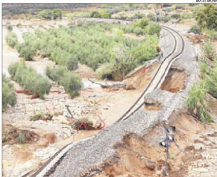
Imatge d'arxiu d'un tram de via danyat als Omellons.
