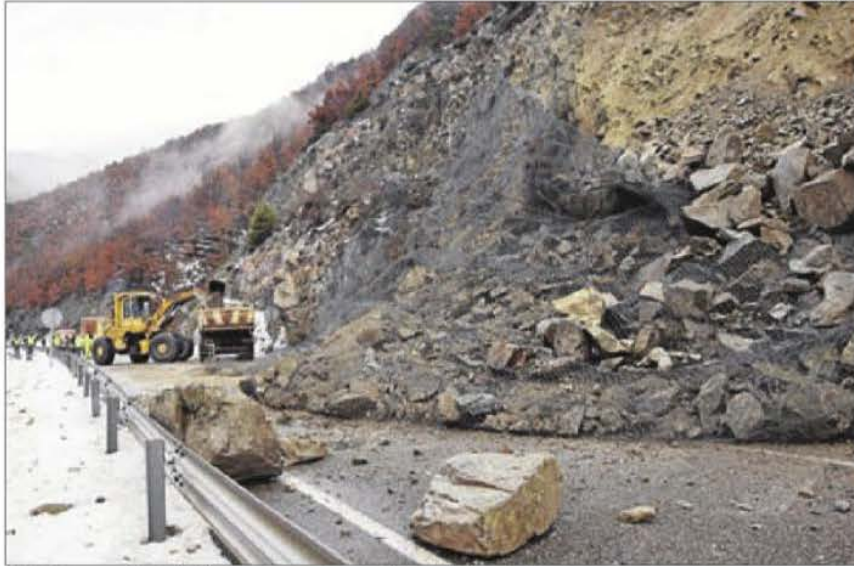
L'N-260 va quedar tallada per un gran desprendiment al Pont de Bar.
