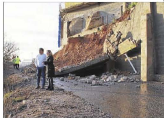
L'aigua s'emporta un pont a Cervià i tira una paret de la residència ■ L'aigua dels rius Set i Gorg es va emportar el pont de la pista a la Pobla de Cérvol i va inundar horts, pous i magatzems a Cervià. A més, va enderrocar un mur de la residència per a la tercera edat que s'està construint.
