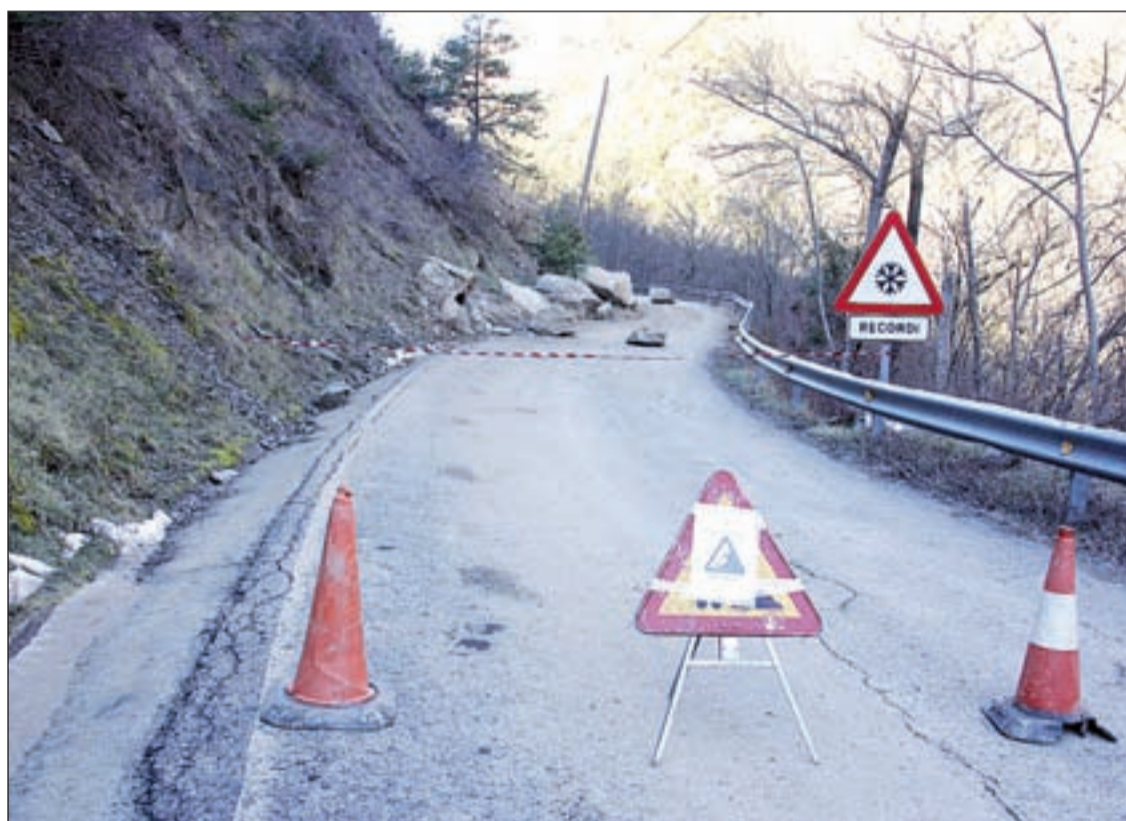
FOTO: ACN/ Imatge del punt on van caure diverses roques, que han obligat a tallar la via
