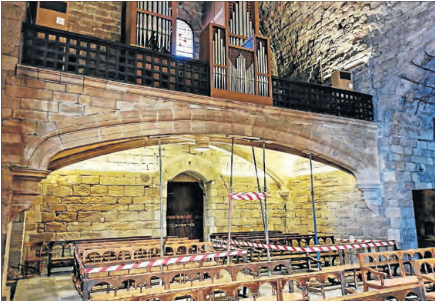
L'arc inferior del cor del temple es troba des d'ahir al matí apuntalat per seguretat i s'ha restringit l'accés a la zona.
