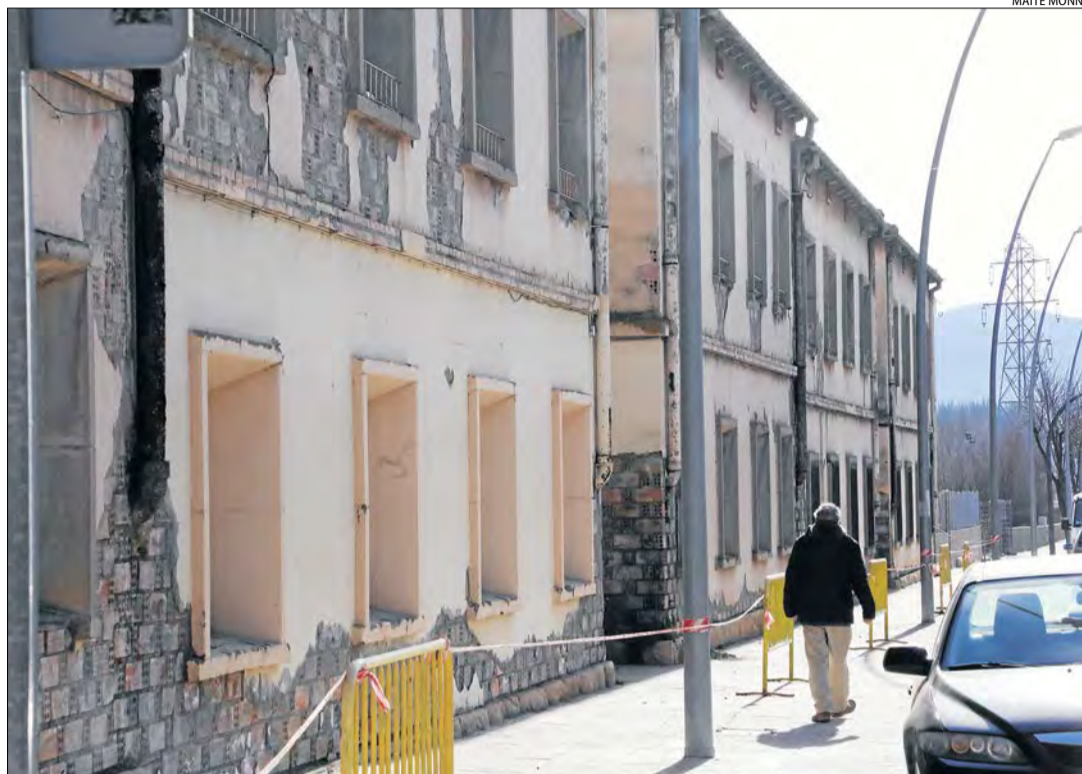
Un home al costat de les antigues cases dels ferroviaris, amb tanques per risc de desprendiments.
