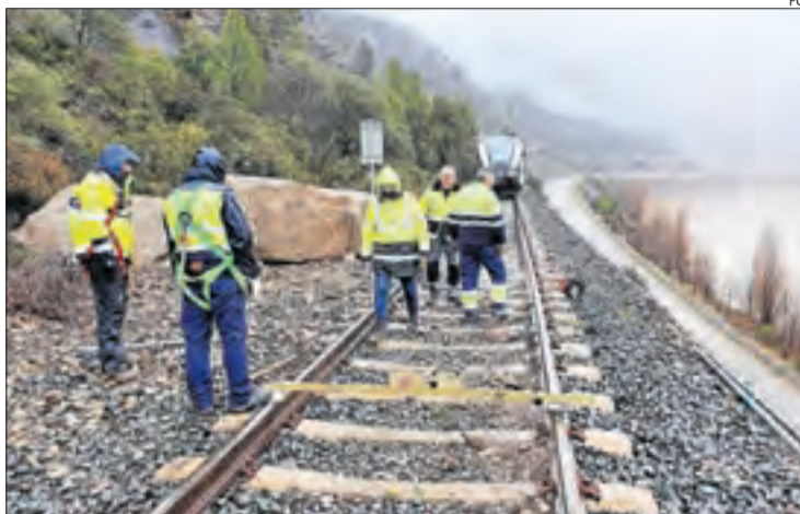
Operaris del tren van arreglar la via el mateix dia 23 de gener.
