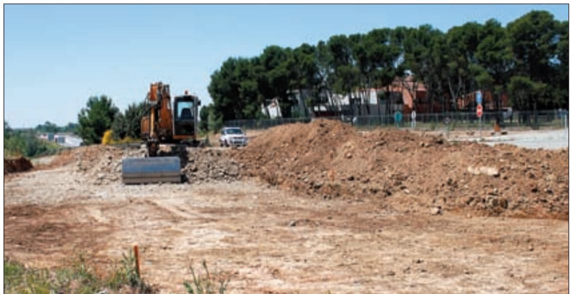
FOTO: Tony Alcántara / Els operaris comencen a desbrossar la zona per on s'habilitarà el pas subterrani
