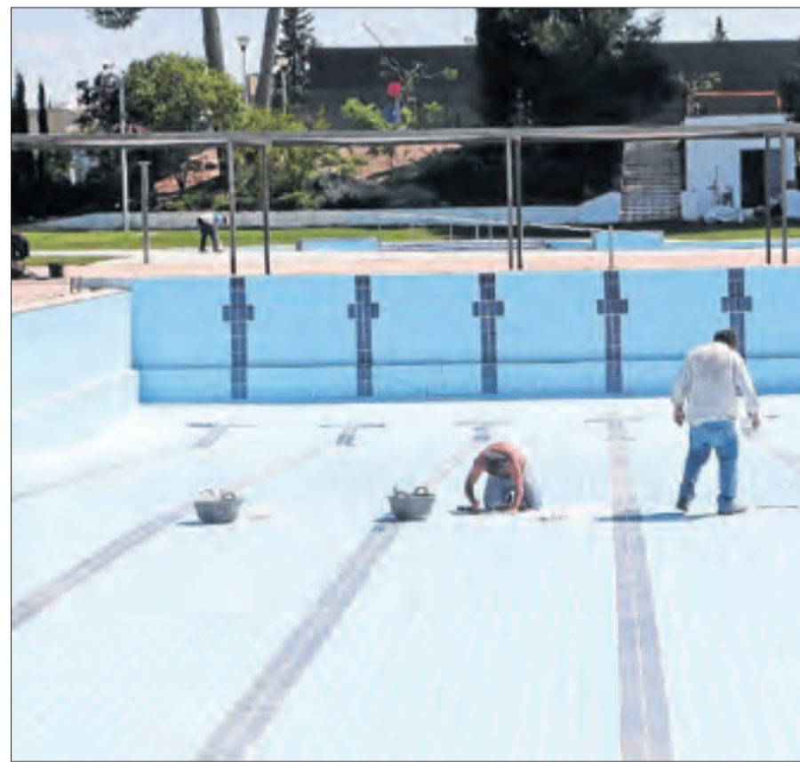
Operaris fent tasques de manteniment a les piscines municipals de les Borges Blanques.
