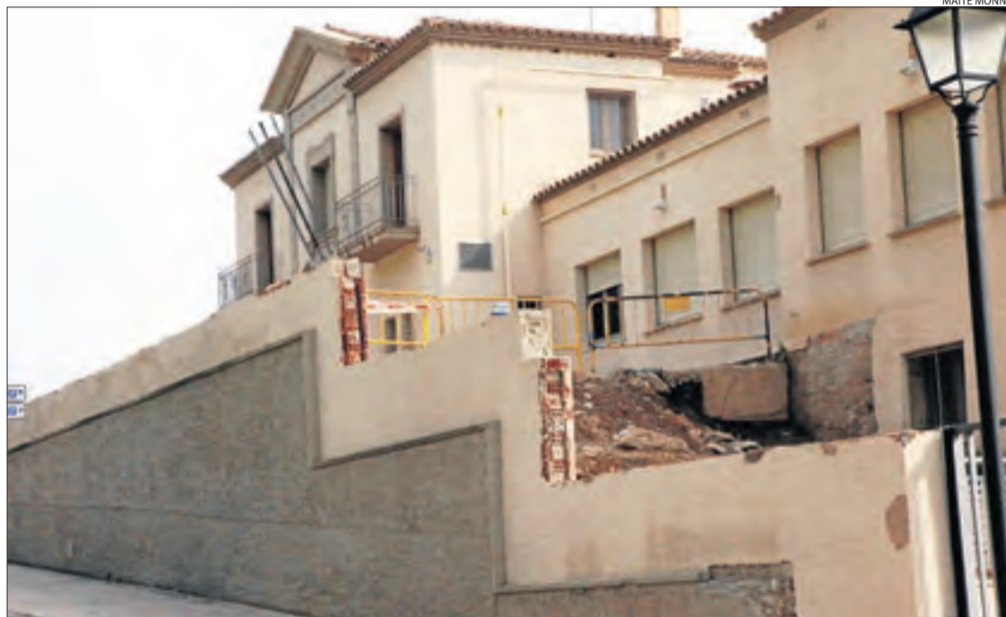
La seu de Justícia, al carrer Sant Martí, un dels punts on s'han reprès les obres.
