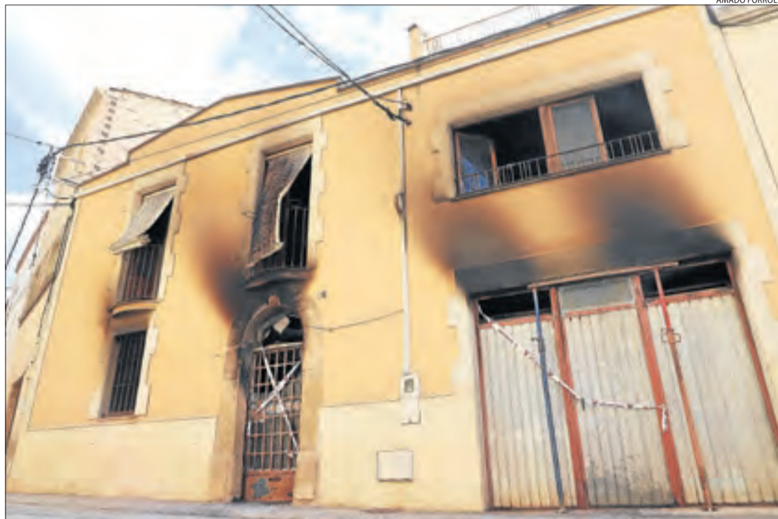
La façana de l'habitatge va quedar en aquest estat després de l'incendi.
