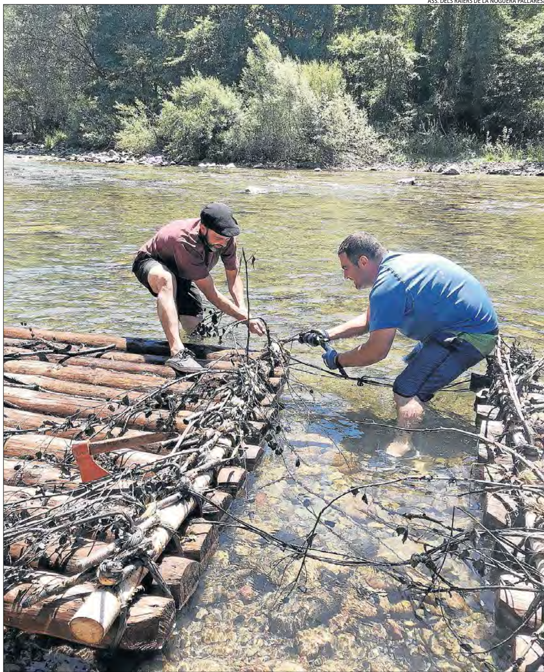
Dos veïns construint el rai que avui descenderà pel riu Noguera Pallaresa.
