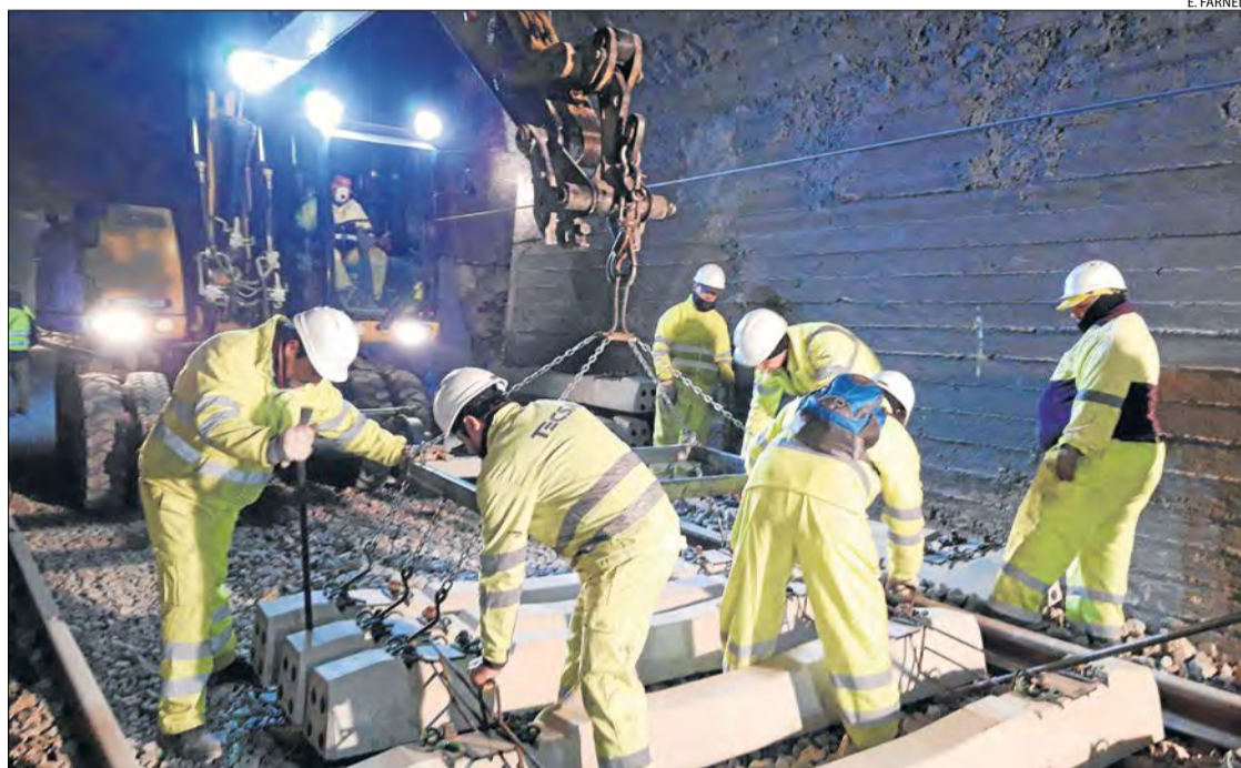
Imatge d'arxiu de les obres de renovació de les vies en un dels túnels l'any passat.
