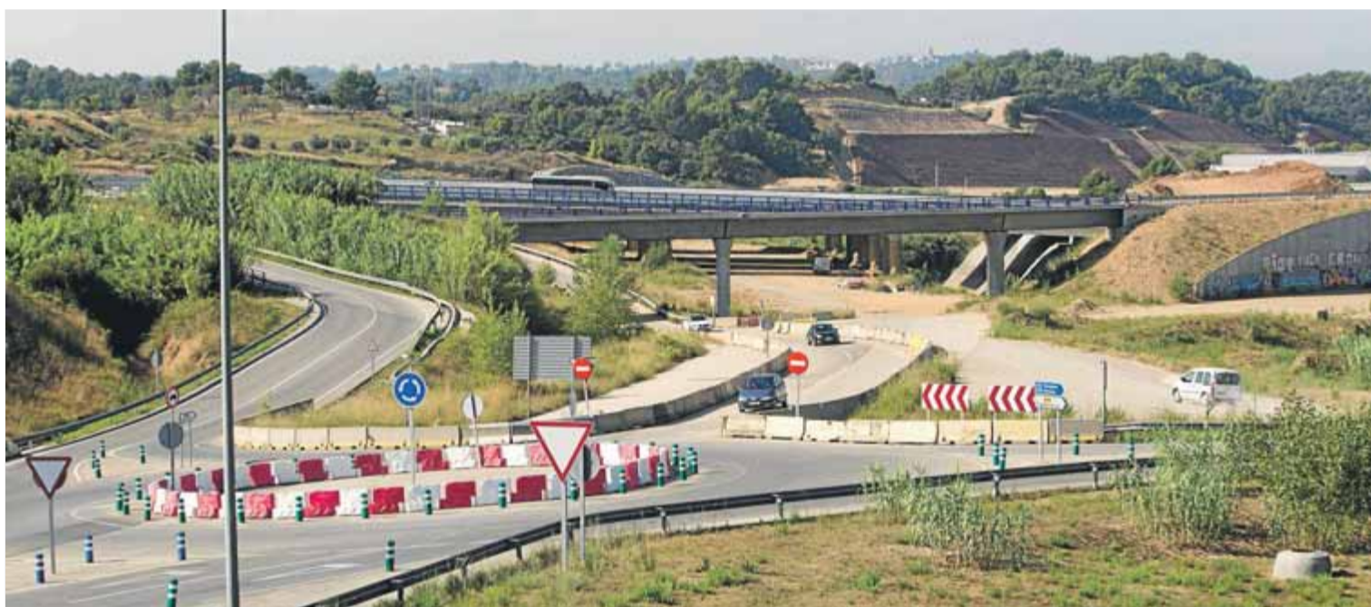
La rotonda que dona accés actualment al quart cinturó des de Terrassa, on s'estan construint els accessos a la C-16 ■ ORIOL DURAN
