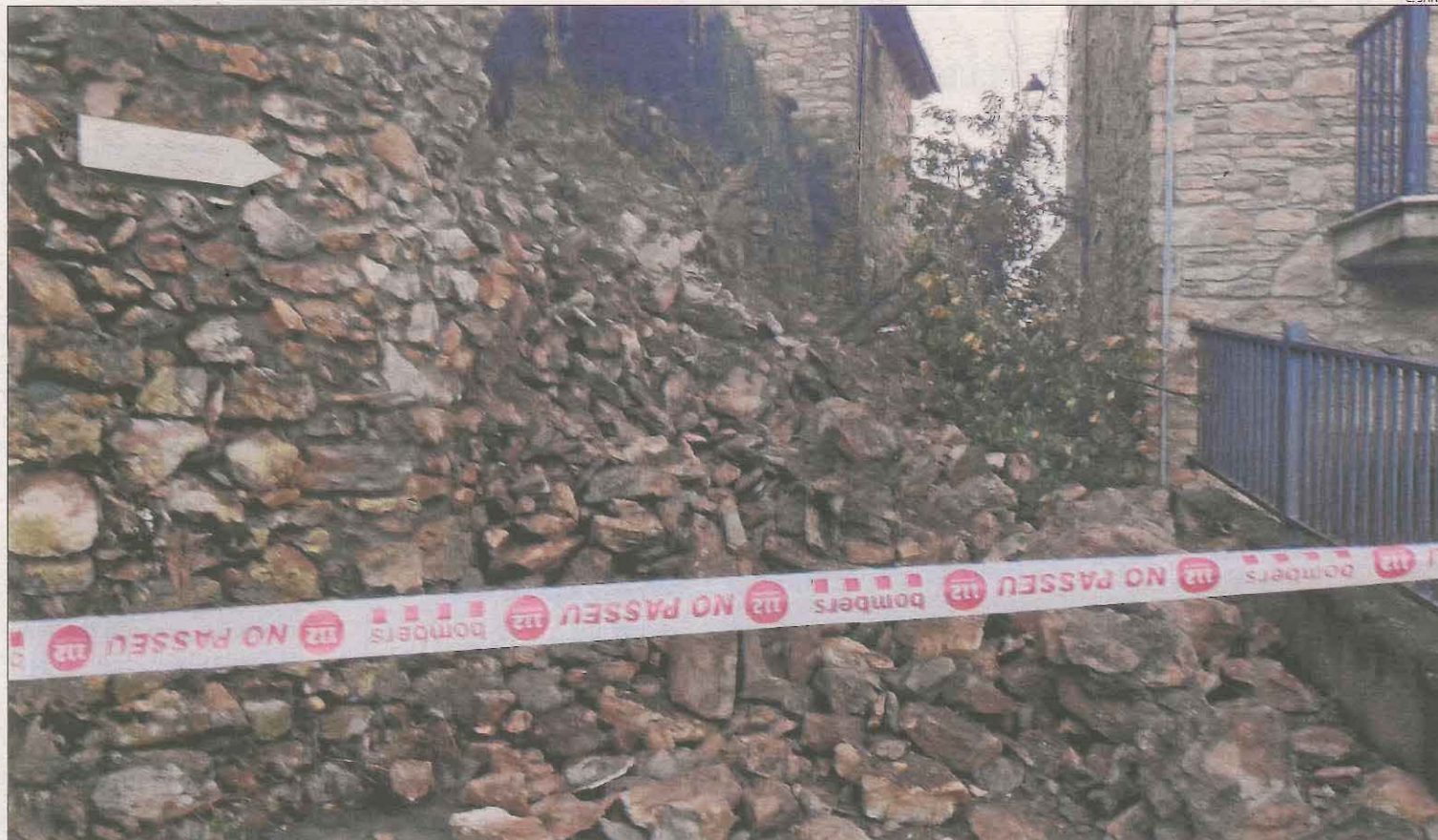
El mur de pedres va cedir a primera hora del matí i va tallar per complet el carrer Major d'aquest poble de l'Alt Urgell.
