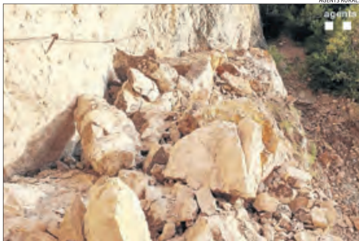
Imatge d'arxiu del desprendiment del dia 12 de novembre.
