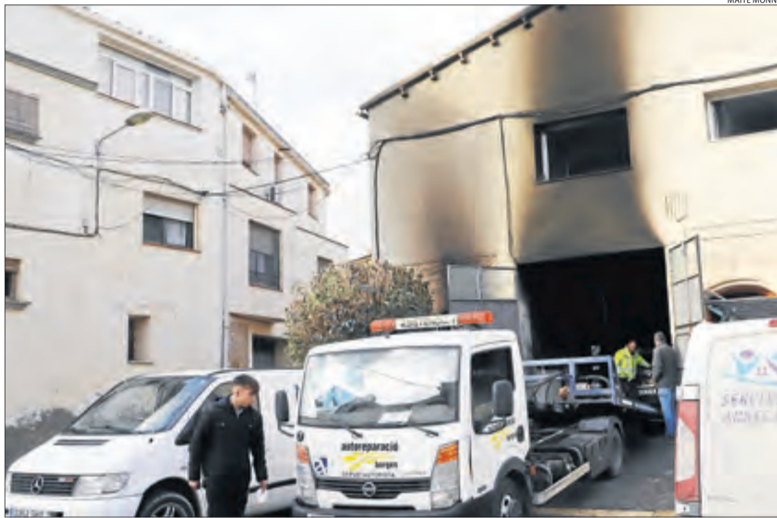
Estat en el qual ha quedat la façana de l'immoble arran de l'incendi.
