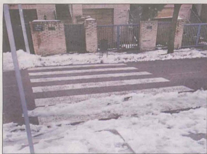
FOTO: FAVT / Estat de la rampa del carrer La Plana de la ciutat
