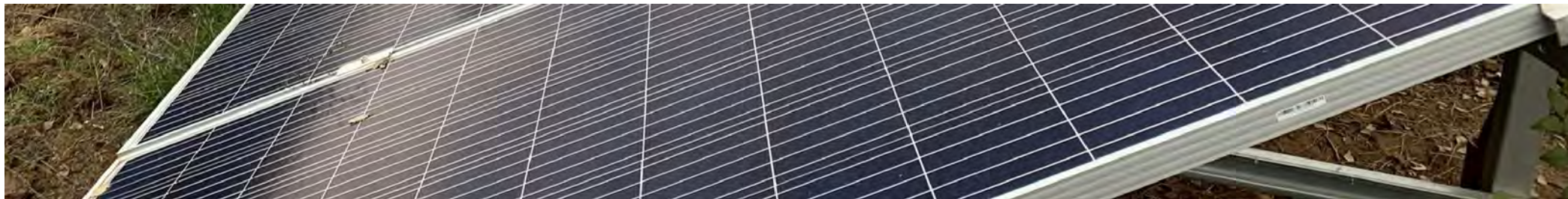
Una instal·lació fotovoltaica a Talarn G.L.T.
