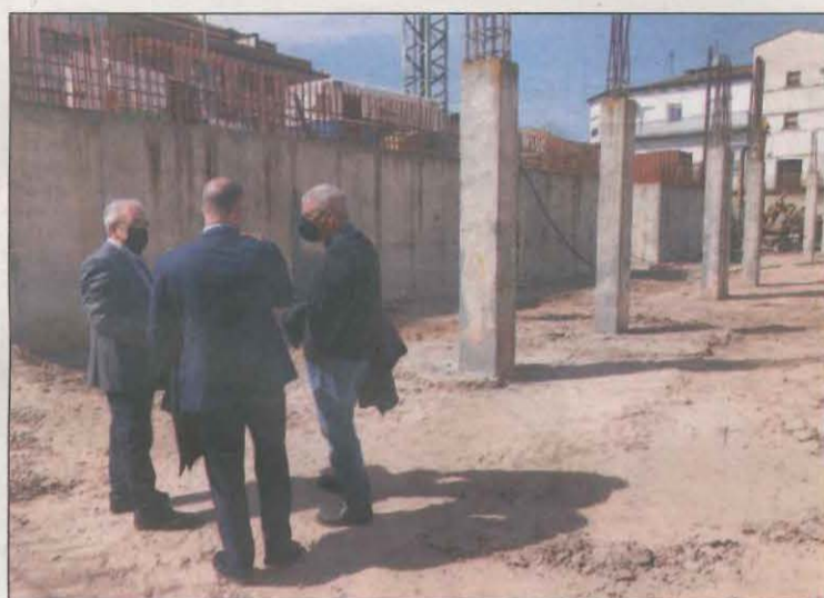
FOTO: Aj. Borges / Inici de les obres a l'Arxiu Comarcal de les Garrigues
