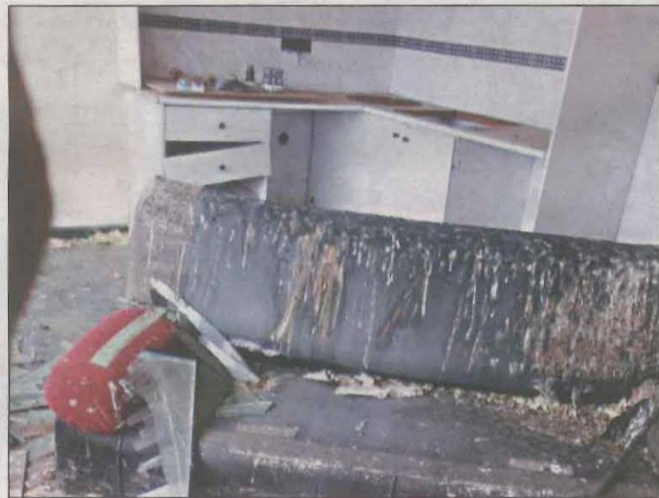
FOTO: AAVV Mariola / Un dels pisos abandonat i ple de brutícia
