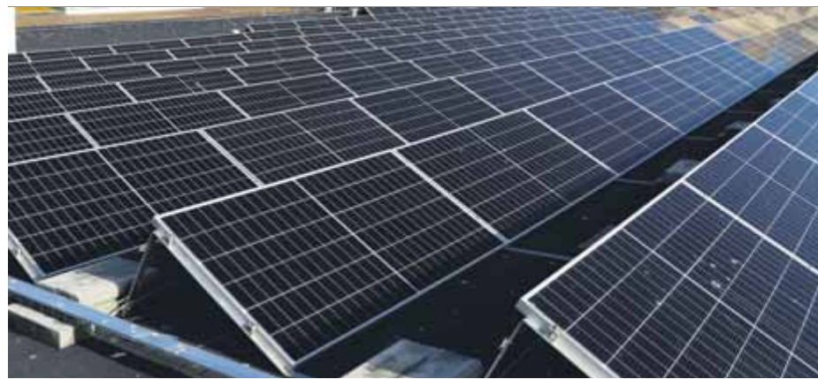
Una instal·lació de plaques solars ■ E.A.
