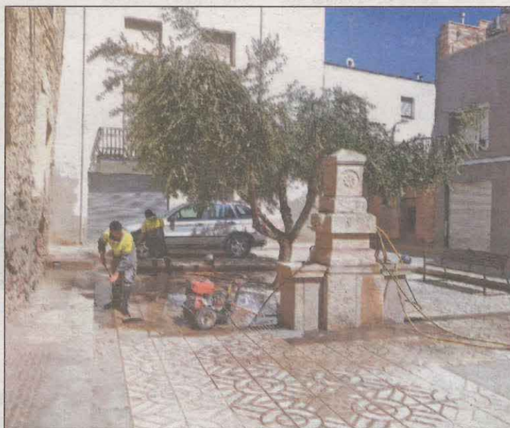
FOTO: Aj. Seròs/ Imatge de les obres que s'hi han dut a terme
