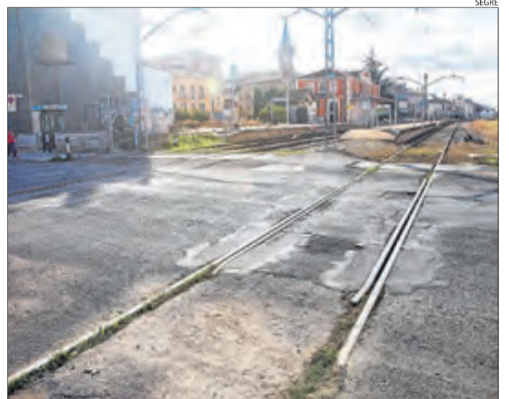
L'estat actual del ferm del pas a nivell de la C-14 a Tàrraga.
