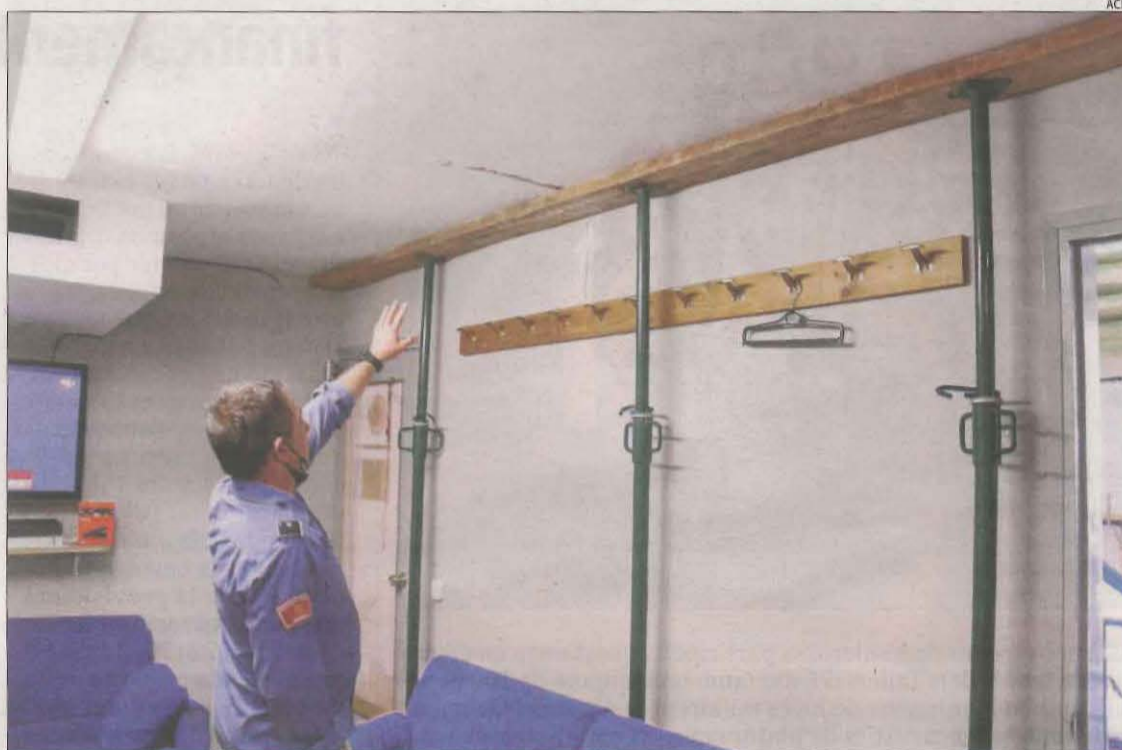
El parc de Seròs ja fa més de cinc anys que està apuntalat.
