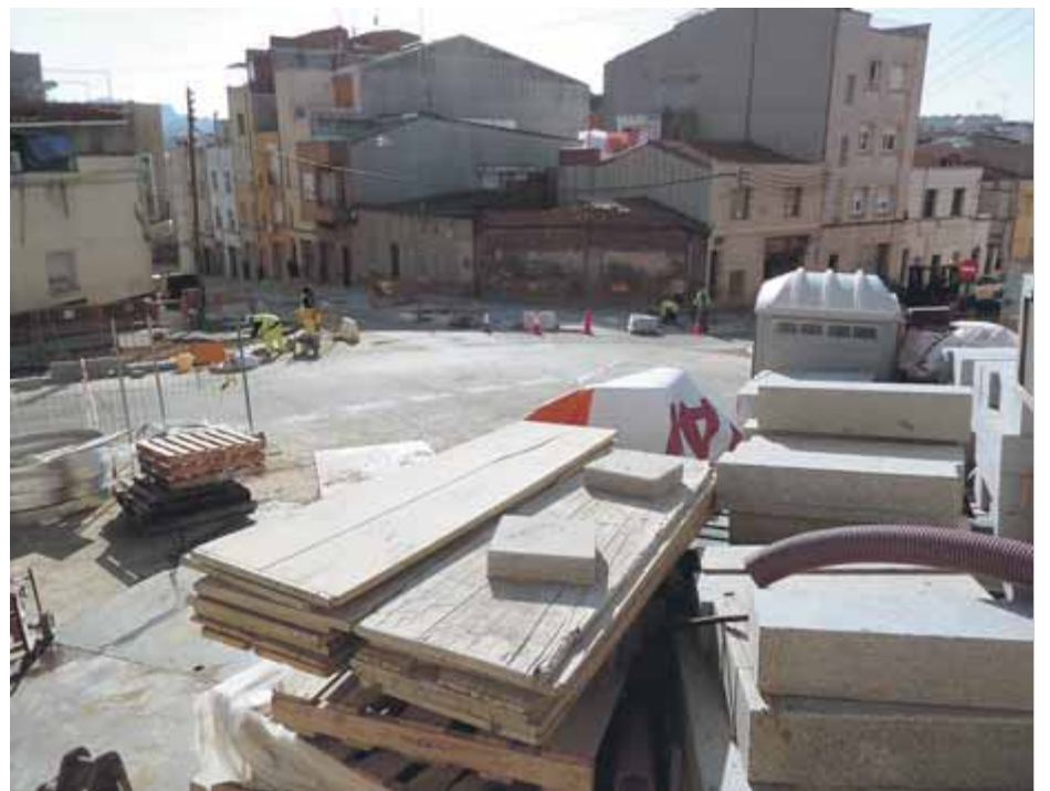
Obres al carrer Dom Bosco, incloses en el pla de barri de La Maurina de Terrassa ■ J.A.
