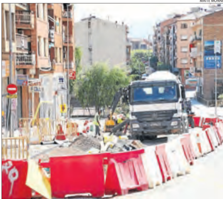
Imatge de les obres de la nova rotonda de la C-13 a Tremp.
