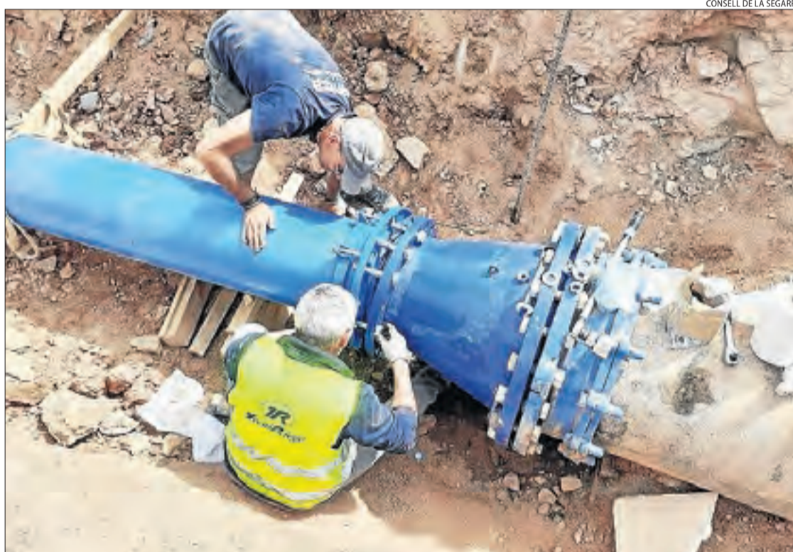
La connexió de la canonada d'emergència a la potabilitzadora de Ratera.
