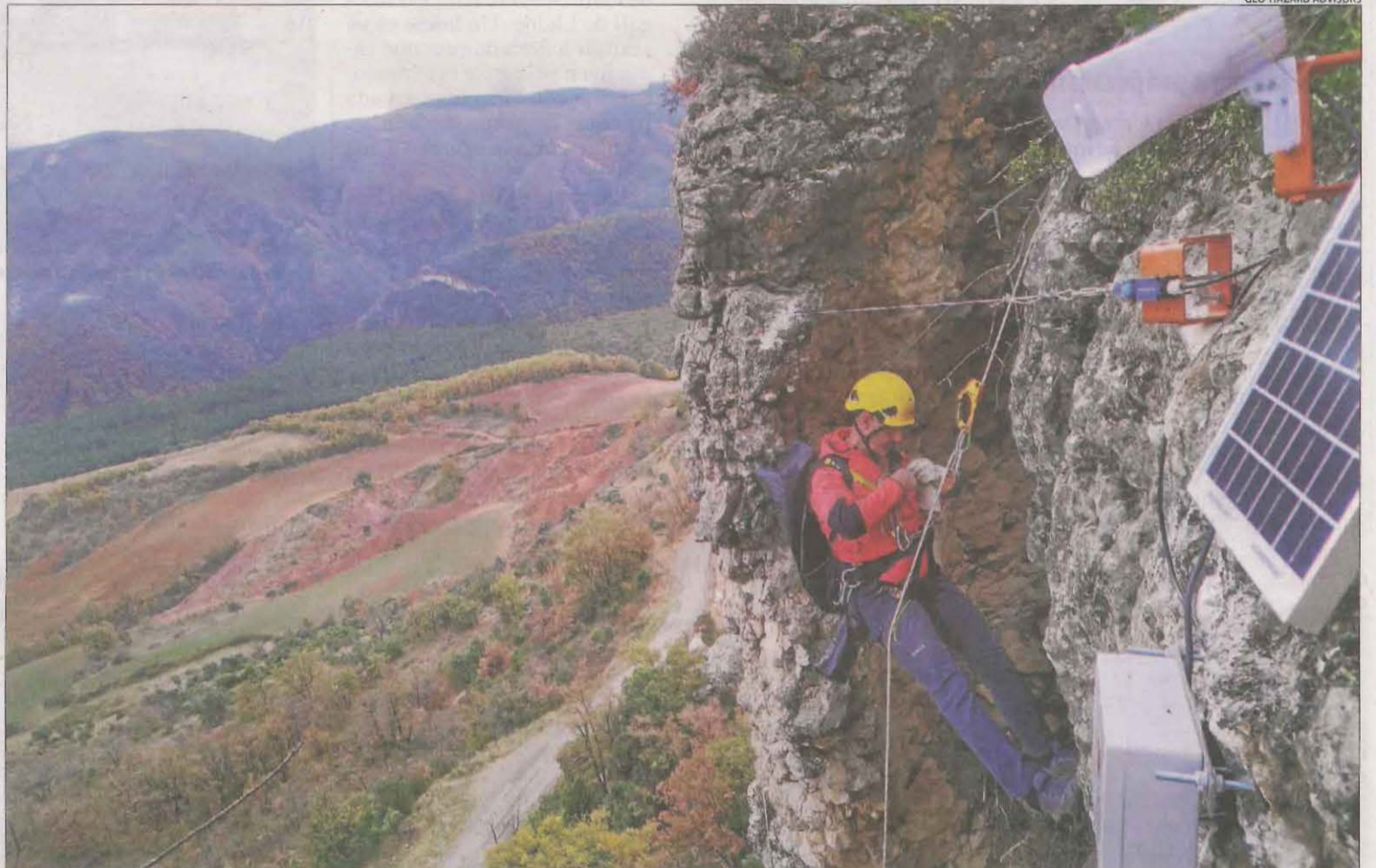
Una de les alarmes instal·lades en un bloc de roques inestable sobre la carretera de Sant Esteve de la Sarga, que dona accés a Mont-rebei.
