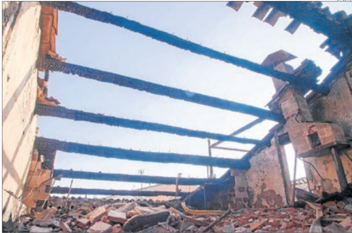
Estat en el qual va quedar la teulada de la casa després de l'incendi.
