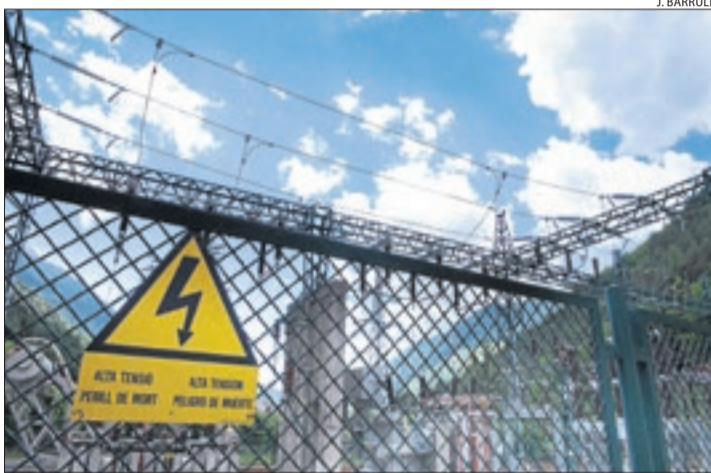
Imatge d'arxiu d'instal·lacions de la central de Capdella.
