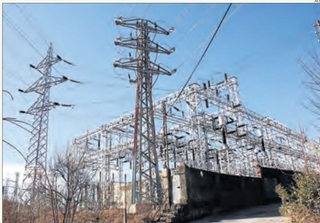
Imatge d'arxiu de la subestació de la Pobla de Segur.
