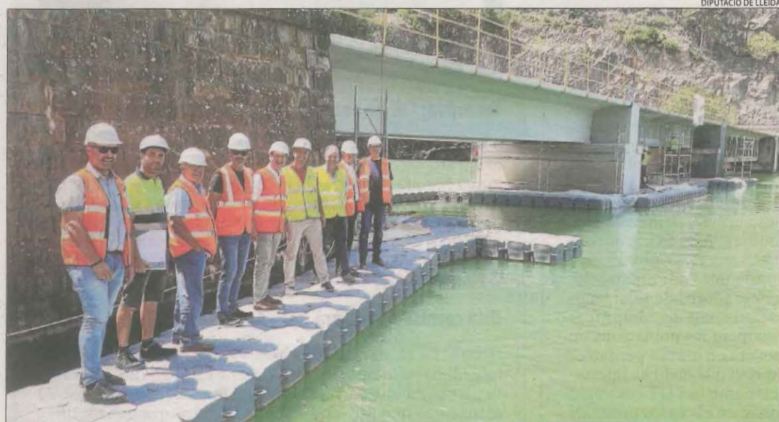
El president de la Diputació, Joan Talarn, va visitar ahir les obres del pont a Llimiana.
