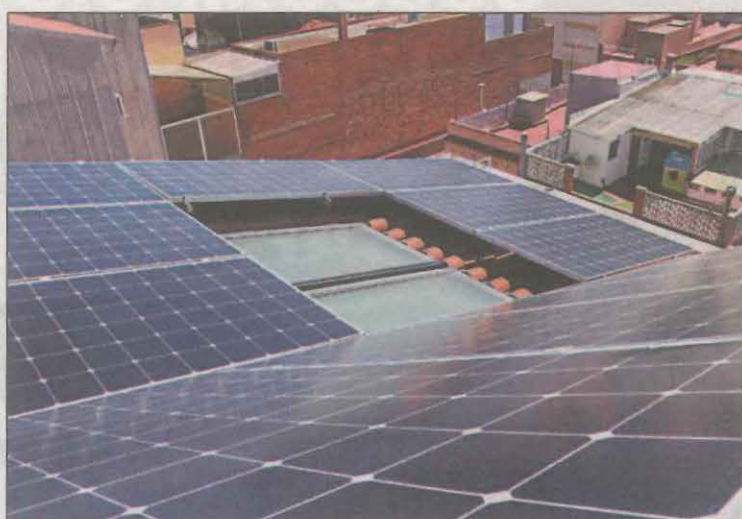
FOTO: ACN / Plaques solars d'autoconsum energètic en un àtic
