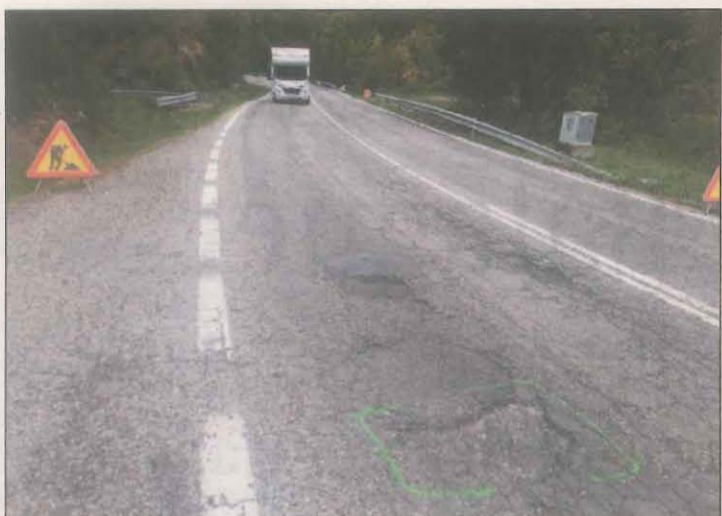
FOTO: N. Castells / La via presenta un estat molt deficient
