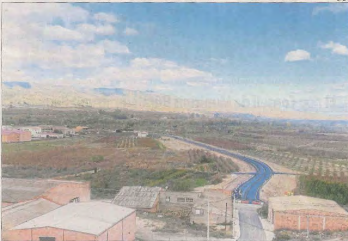
Vista aèria de les obres de la variant de la Granja d'Escarp.
