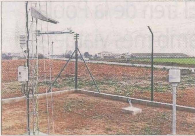
L'estació meteorològica instal·lada a Menàrguens.
