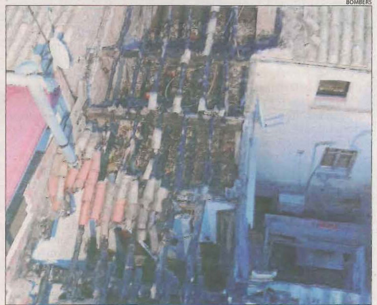
Vista aèria de l'estat en el qual va quedar la teulada.
