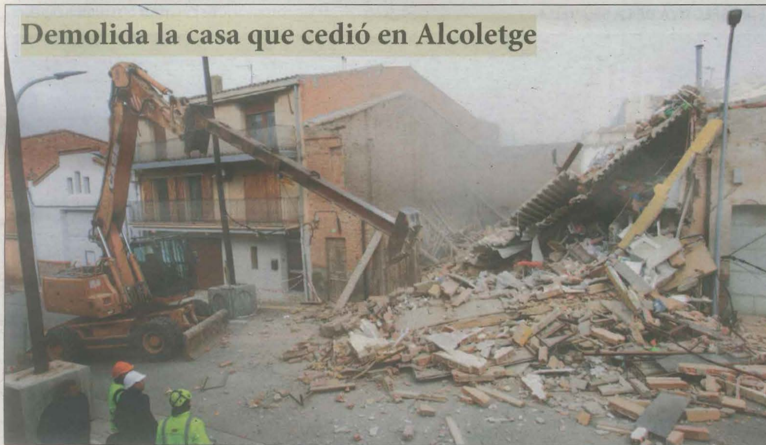
FOTO: Tony Alcántara / Una máquina procede al derribo del inmueble que el pasado sábado sufrió un derrumbe parcial
