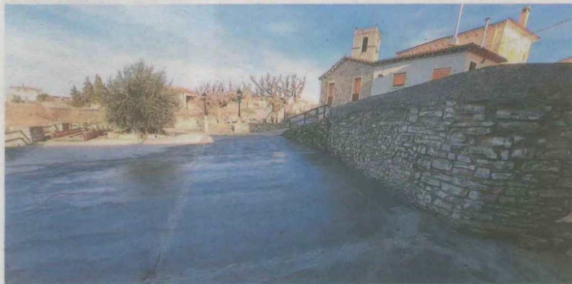
FOTO_Aj. Sant Ramon S'ha reforçat el mur de la plaça de les Pletes del Portell
