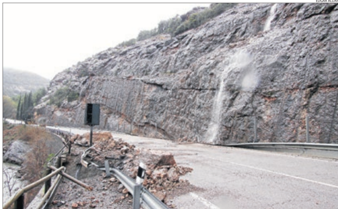
L'N-260 a Collegats, a la imatge parcialment neta, va quedar tallada i avui s'inspeccionarà.
