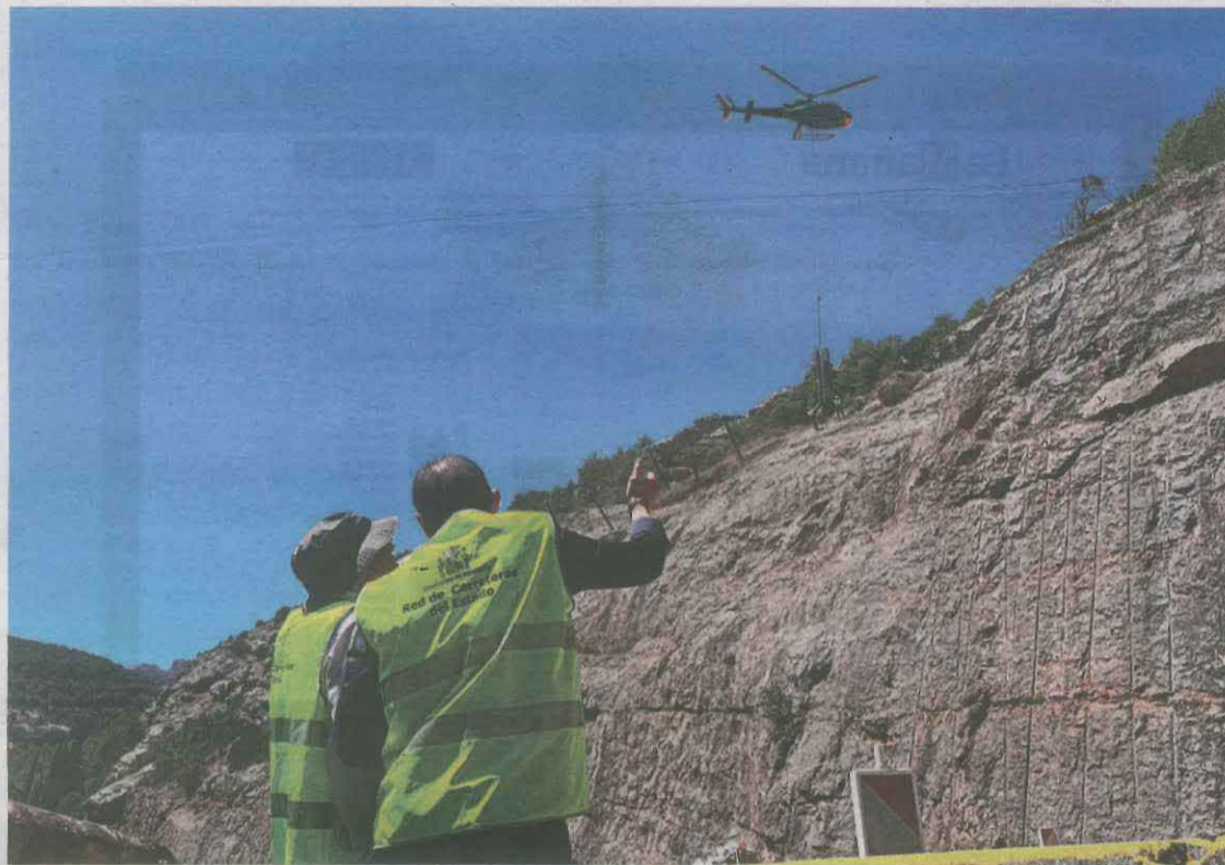
FOTO_ Subdelegació Crespín va visitar ahir la zona per comprovar l'estat de les obres
