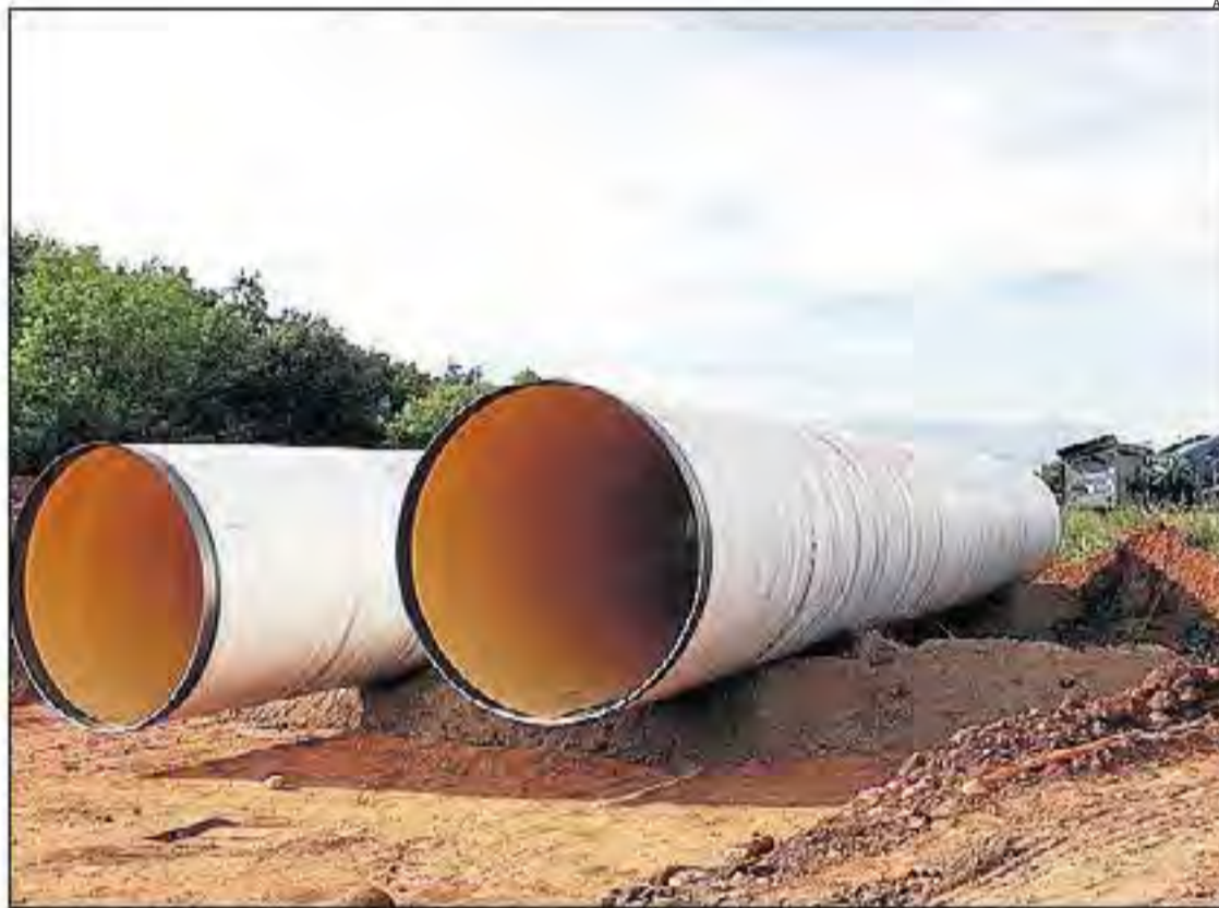
Imatge de la canonada per executar la primera fase d'ampliació del reg de la Conca de Tremp.
